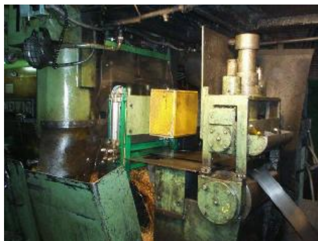
Obr.3 Stírací zařízení SZ 500 v provozu
